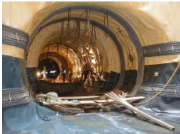
Foto: Injektionsleitungen im Sarnafil Waterstop System bei einem Querschlag mit Übergang zum Schacht, NBS Köln – Rhein/Main
