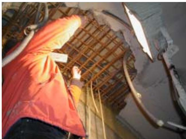
Foto: Betonierfehler im Gewölbe, NBS Köln – Rhein/Main
